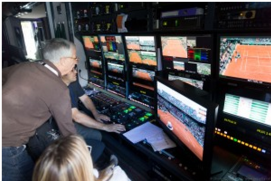
La zone des CCU (Camera Control Units) du car régie de France Télévisions avec la réception de signaux 4K. Le car est équipé en connectique SDI 3 gbits/s adaptable à la HD et à la 4K. Reste à passer à la fibre optique !
